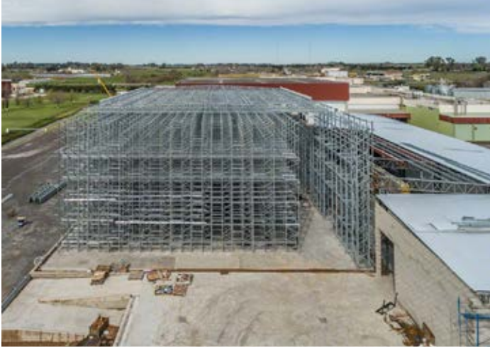
Almacén autoportante con cámara para producto congelado.
